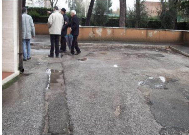
Foto 2 Manto stradale dissestato in inverno
