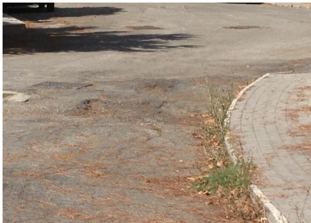
Foto 3 Manto stradale dissestato in estate
