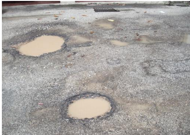
Foto 1 Manto stradale dissestato in inverno
